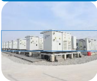
宁夏宁储利通区板桥 共享储能电站项目
