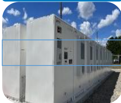
北美FLEXGEN 共享储能项目
